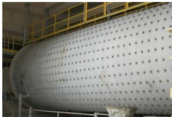
Molino de bolas para la molienda de la mezcla clinker-yeso
