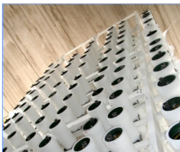
Bastidor de membranas de ósmosis
