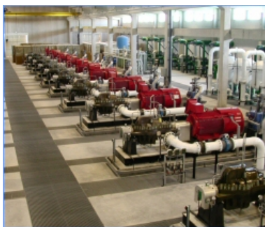
Bombeo de alta presión
