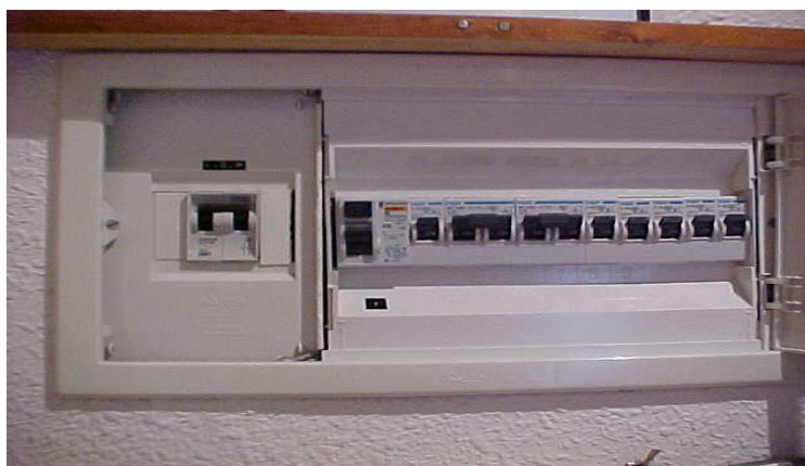
Vista d'un quadre elèctric convencional
