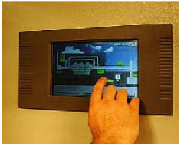
Detall d'una pantalla tàctil de control d'una instal·lació domòtica
