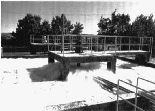
La contaminación producida por una depuradora de aguas en el origen de una denuncia ( Nombre propio , a las 11.20 h).
