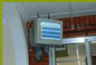
El sistema en funcionamiento real:
