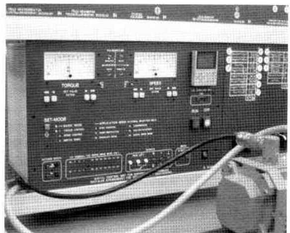
Detalle de la Unidad de Control Digital.
